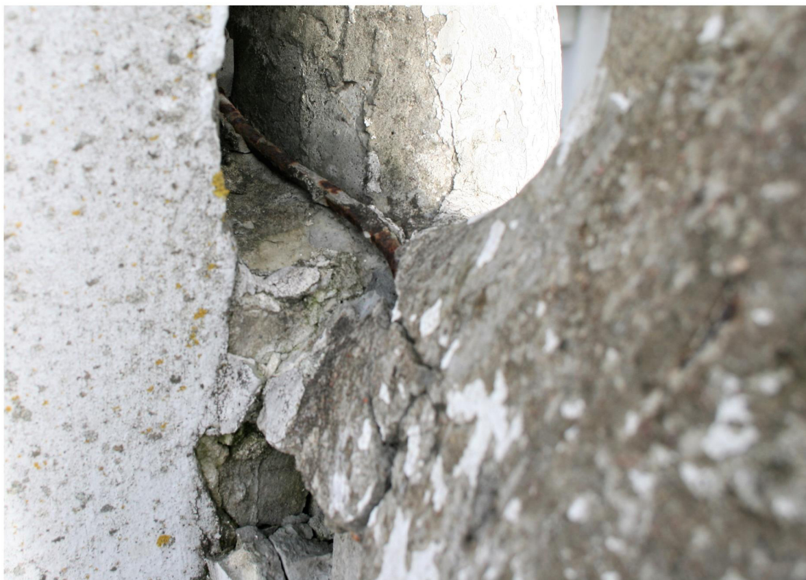
NOWOGRÓD, POMNIK MŁODYM BOHATEROM 1920. ORZEŁ – PĘKNIECIE U NASADY SKRZYDŁA, PÓŹNIEJSZE UZUPEŁNIENIA ZAPRAWAMI CEMENTOWYMI ,WIDOCZNE ODSŁONIĘTE, SKORODOWANE ZBROJENIE
