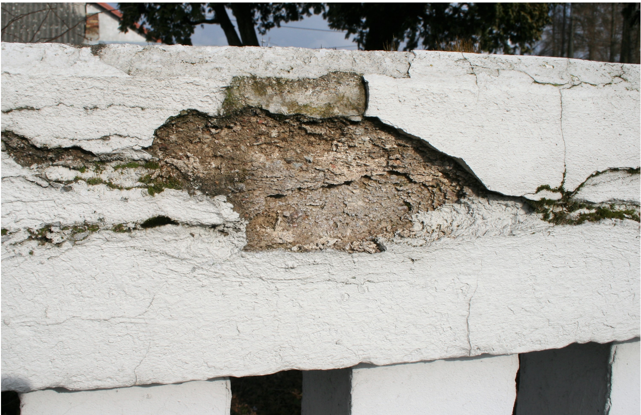
NOWOGRÓD, POMNIK MŁODYM BOHATEROM 1920. KOROZJA BETONU
