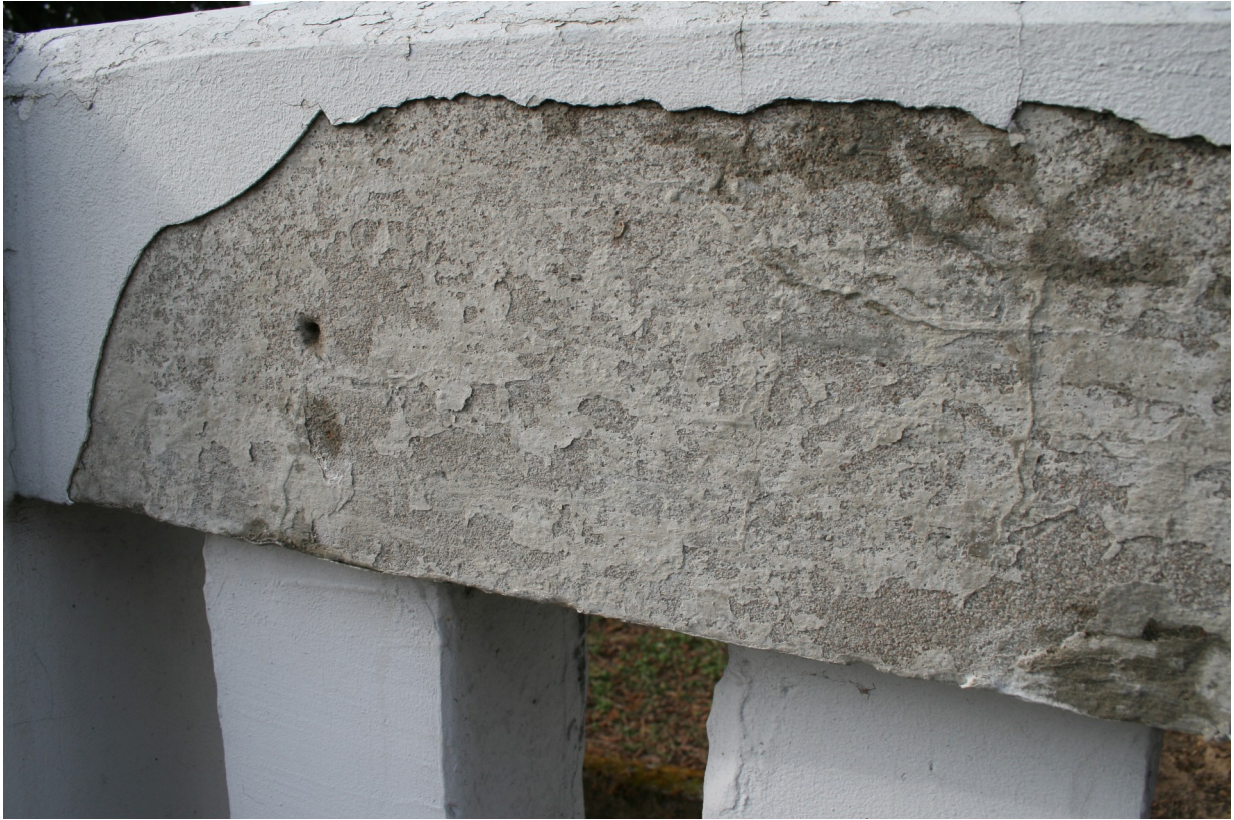
NOWOGRÓD, POMNIK MŁODYM BOHATEROM 1920. FRAGMENT. WARSTWY NAPRAWCZE NAKŁADANE BYŁY NA NIEOCZYSZCZONĄ POWIERZCHNIĘ CO WPŁYWAŁO NA ICH SŁABĄ PRZYCZEPNOŚĆ DO PODŁOŻA
