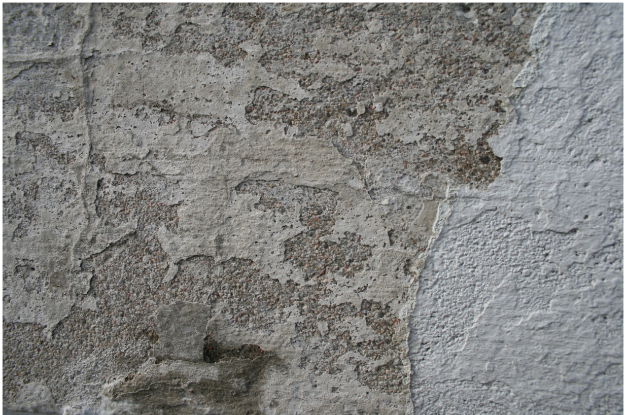
NOWOGRÓD, POMNIK MŁODYM BOHATEROM 1920. WIDOCZNE KILKA WARSTW FARB I CIENKICH ZACIEREK. WIDOCZNA JEST TAKŻE PIERWSZA, ORYGINALNA, SILNIE PRZEMYTA WARSTWA BIAŁEJ FARBY, PRAWDOPODOBNIENIE MLECZKA WAPIENNEGO LUB WAPIENNO CEMENTOWEGO CEMENTOWEGO
