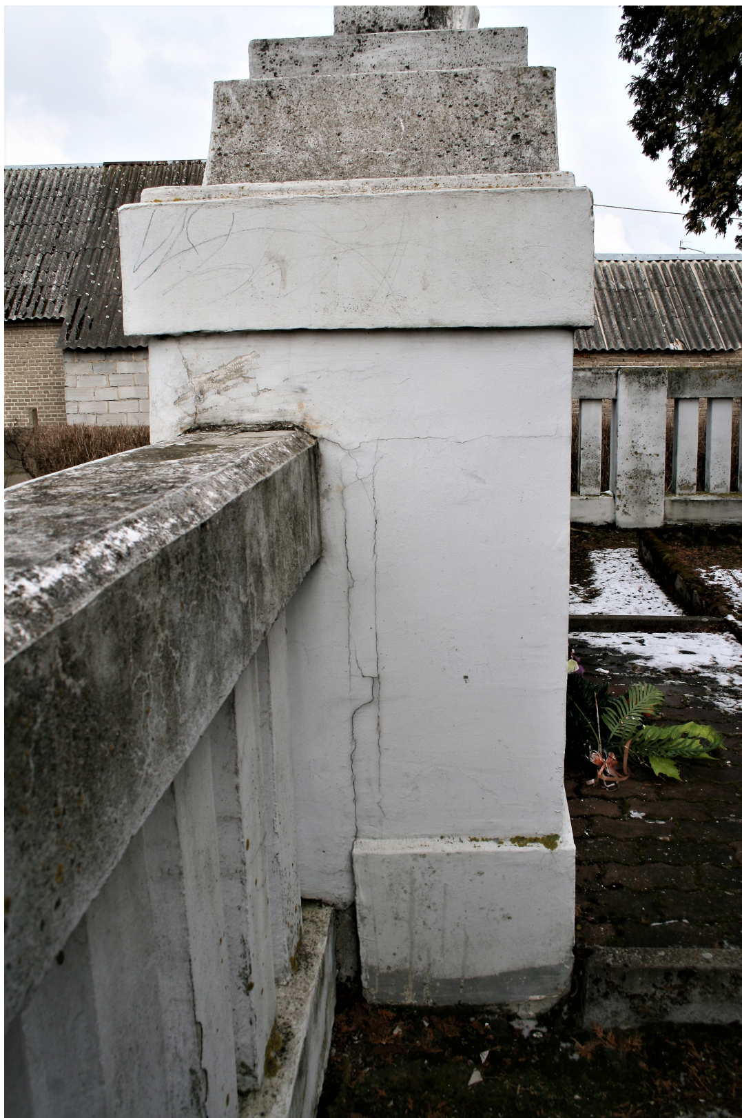
NOWOGRÓD, POMNIK MŁODYM BOHATEROM 1920. UWIDOCZNIĄ SIĘ LICZNE SPĘKANIA POWIERZCHNIOWE ORAZ PĘKNIĘCIA W MIEJSCACH ŁĄCZENIA POSZCZEGÓLNYCH BETONOWYCH ELEMENTÓW
