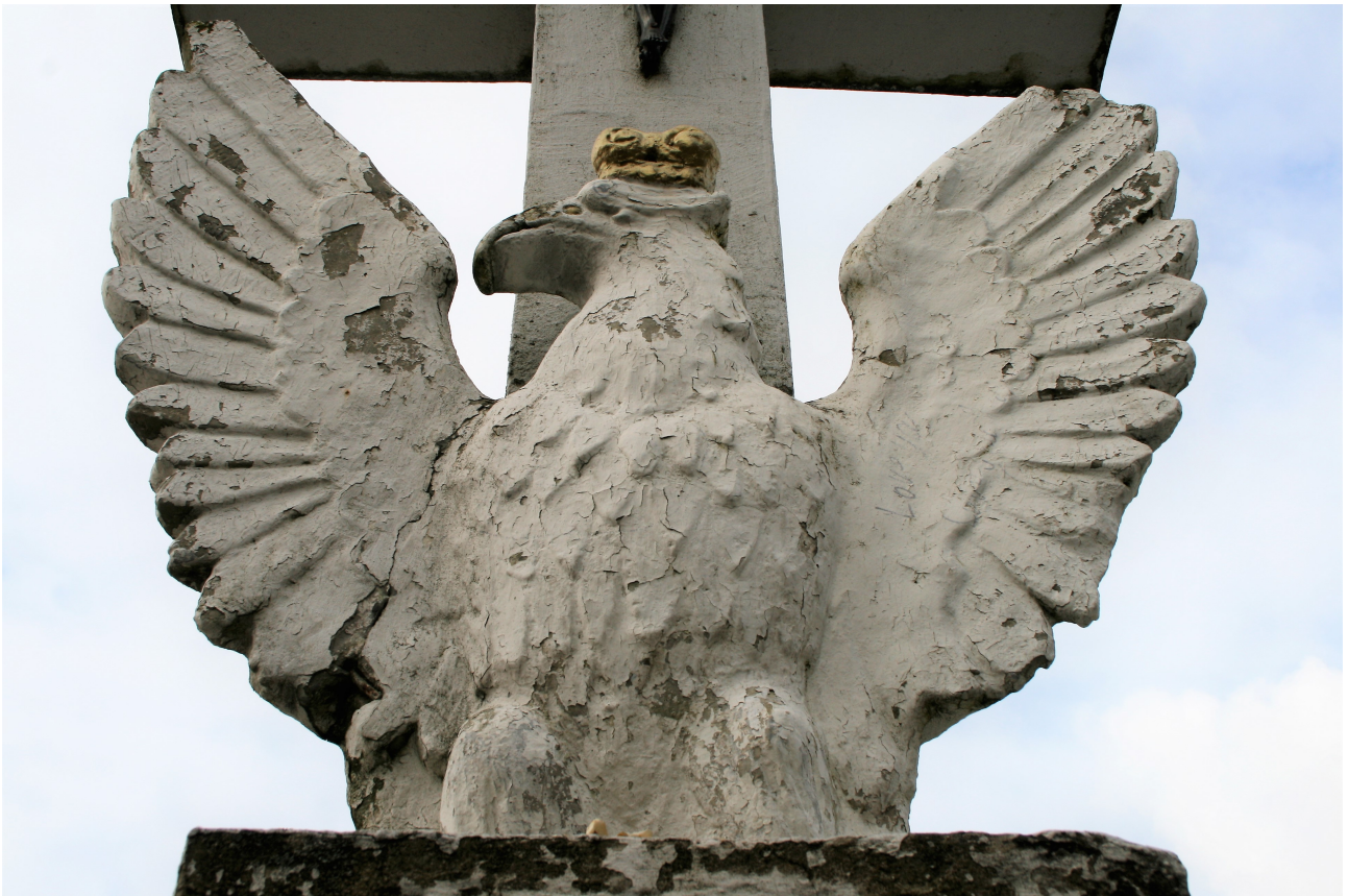
NOWOGRÓD, POMNIK MŁODYM BOHATEROM 1920. KORROZJA BETONU NOWOGRÓD, POMNIK MŁODYM BOHATEROM 1920. ORZEŁ – WIDOCZNE SPĘKANIA I ZŁUSZCZENIA POWŁOK POWIERZCHNIOWYCH, PĘKNIECIE U NASADY SKRZYDŁA, UBYTKI FORMY
