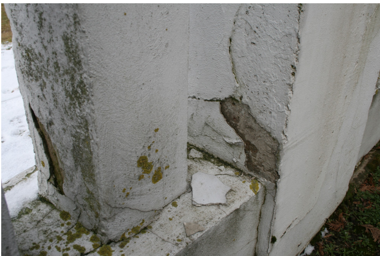
NOWOGRÓD, POMNIK MŁODYM BOHATEROM 1920. FRAGMENT. NA CAŁEJ POWIERZCHNI WIDOCZNE JEST ZŁUSZCZANIE I ODSPAJANIE WARSTW POWIERZCHNIOWYCH – SZPACHLI, WARSTW FARBY CZY WIĘKSZYCH, PÓŹNIEJSZYCH UZUPEŁNIEŃ.
